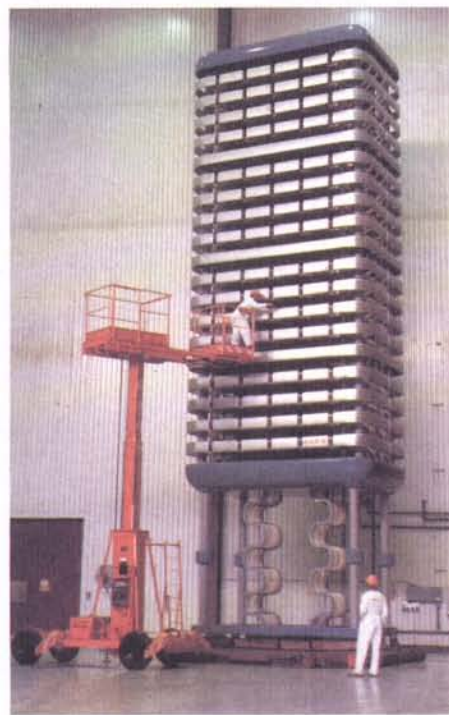
I tyristorventiler för kraftverksbyggen ingår PEX-rör från Wirso och profiler från SAPA.
