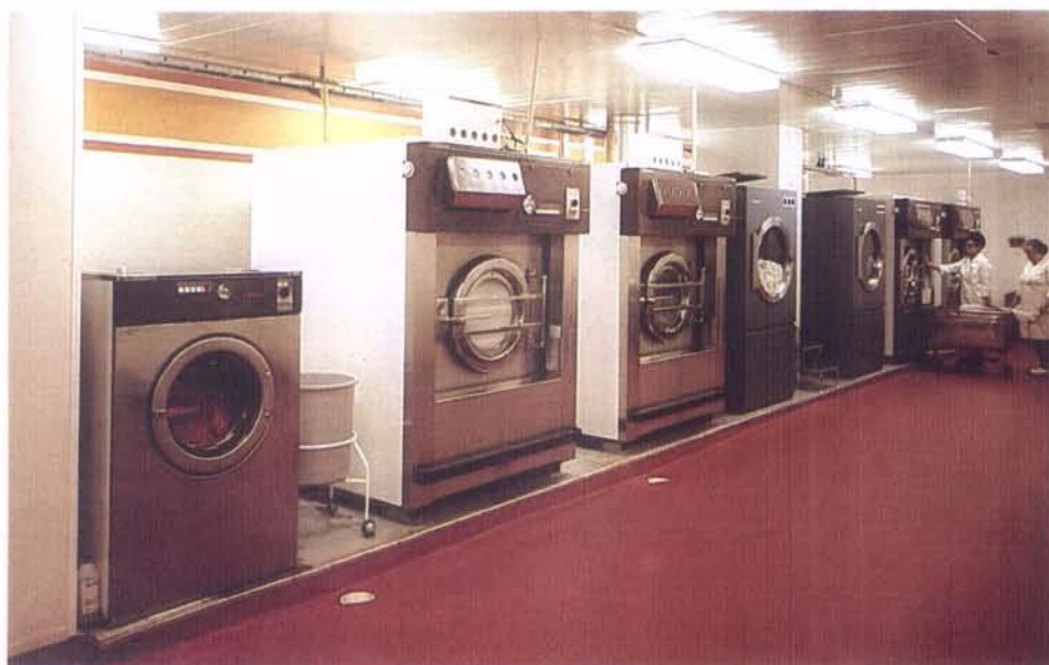
Utrustning för fastighets- och sjukhustvättstugor – en av koncernens specialiteter.
