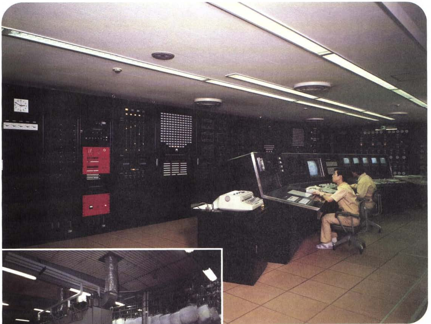
Del av "totalt servicepaket". Personal från koncern-bolaget NESCO Ltd under arbete i kontrollrummet till en kontorsfastighet i Tokyo.
