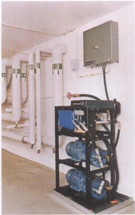
Centralenhet med högtrycks-pumpar och automatiskskåp
