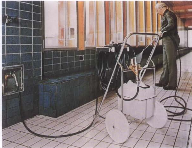
Mobil enhet med anslutning till vägguttag
