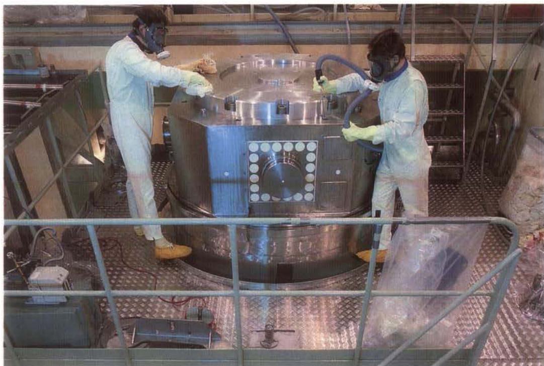
Utöver traditionell städning av kontor och offentliga miljöer utför ASAB även rengöring av starkt nedsmutsade miljöer inom industrin. Bilden visar saneringsarbete vid kärnkraftverket i Ringhals.
