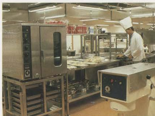
Storköksutrustning levereras ofta i projekt, som omfattar alla moment från projektering till installation och service.
